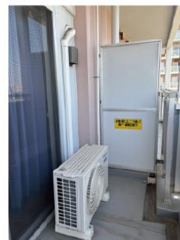
⑤室外機と周辺
