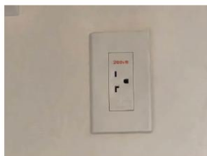
①室内機のコンセント
