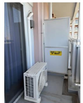
⑤室外機と周辺
