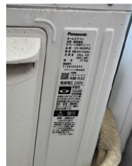
④室外機の銘板
