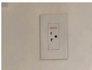
①室内機のコンセント
