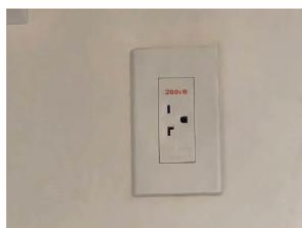
①室内機のコンセント
