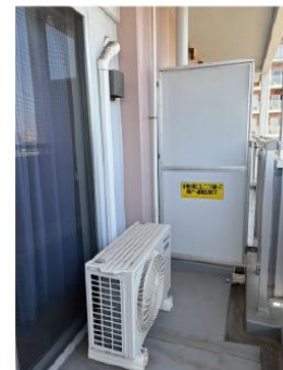
⑤室外機と周辺
