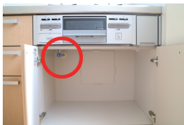
コンロが設置されている棚の 扉を開き、ガス配管の写真
